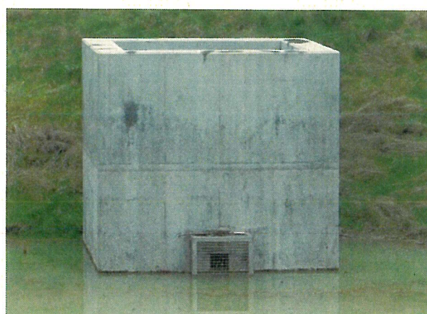
⑤ 3号調節池オリフィス
