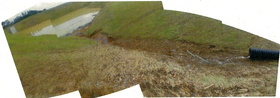
⑥2号調節池流入部の配管が外れ、池内側の一部法面を洗掘した
